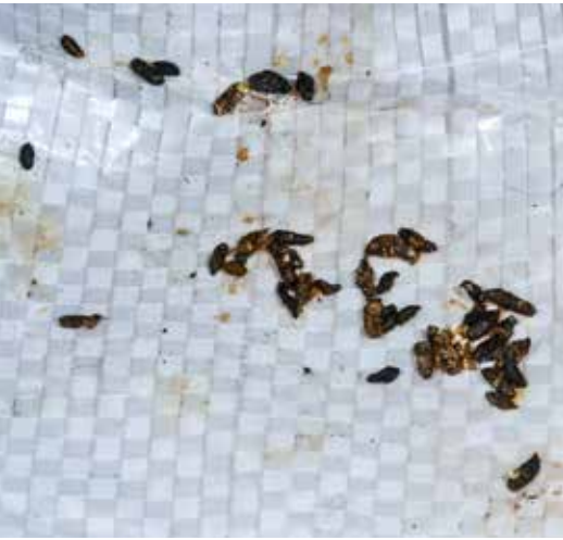
Die Mäuse nisteten in Wänden und Holzstrukturen im Gebäude. Mäusekot fand sich überall im Gebäude. Foto: Dr. Reiner Pospischil
